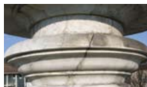
Diagonalriss unterhalb der kleinen Brunnenschale
