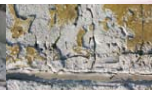
Verwitterte und gerissene Oberfläche der großen Brunnenschale
