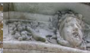
Verkrustungen der großen Brunnenschale
