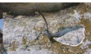
Frostspaltung an der Oberseite der großen Brunnenschale
