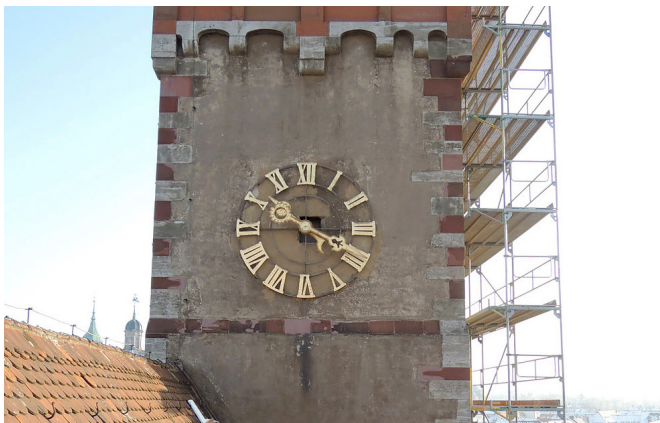
Der Zahn der Zeit: Was Korrosionen verursachten, wurde ausgebessert.
