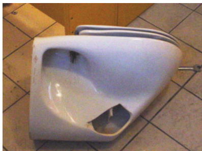
1. WC Schaden, JUZ Grombühl
