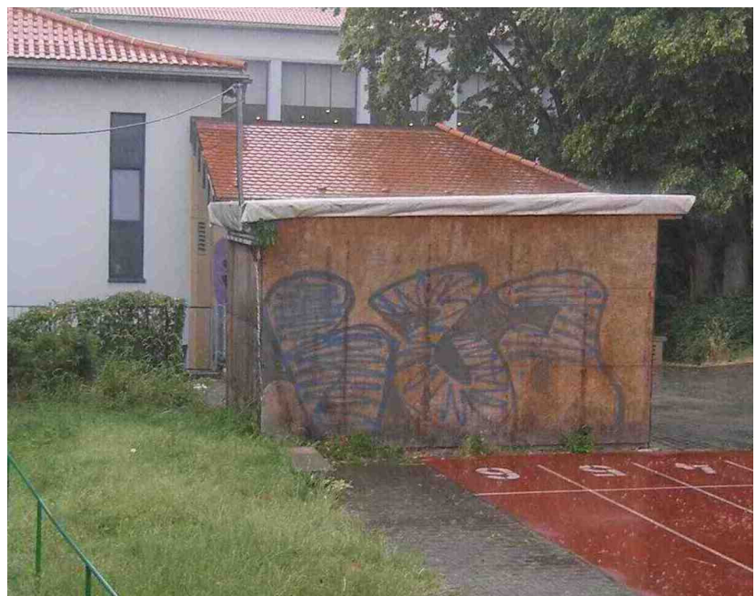
4. Graffiti-Schmiererei, Nebengebäude Sportanlage Sanderrasen
