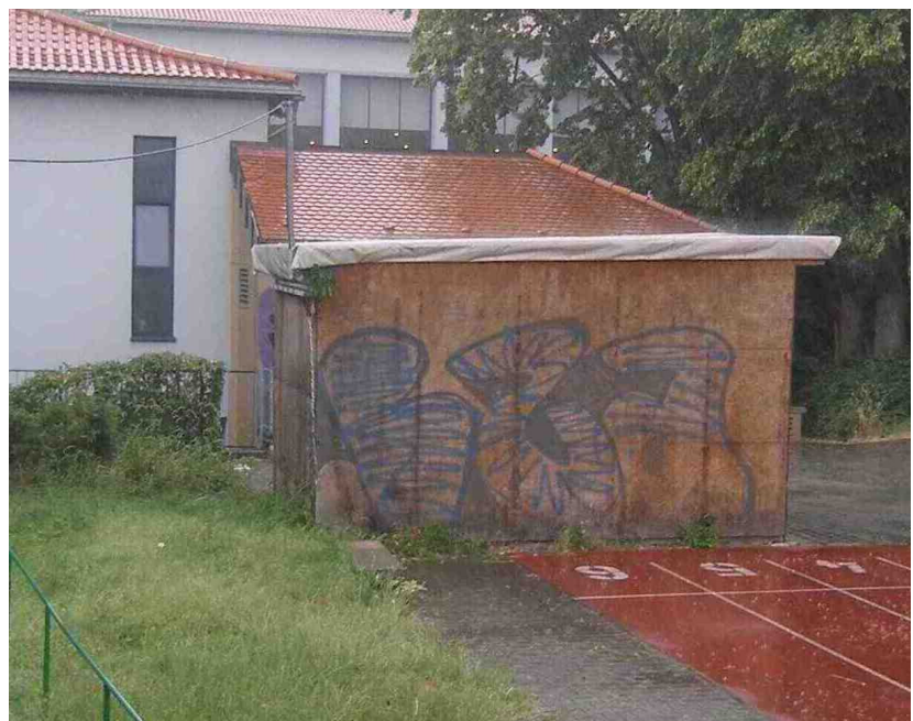
4. Graffiti-Schmiererei, Nebengebäude Sportanlage Sanderrasen
