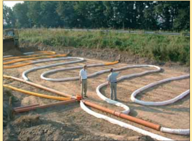
Verrieselungsanlage für das Regenwasser über dem Erdkollektor Foto: Schwalger, Goch
