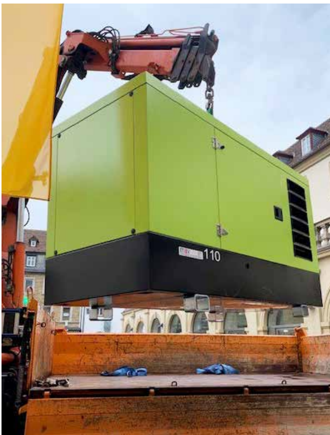
Notstromaggregate sollen auch das Rathaus mit Strom versorgen. Foto: Jürgen Semmel
